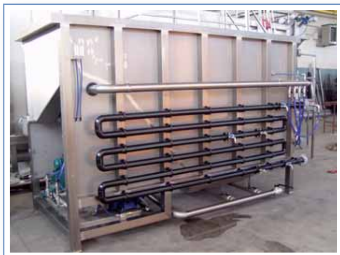
Impianto di Flottazione con flocculazione on-line.
