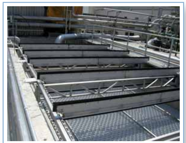
Ponte raschiatore di superficie
